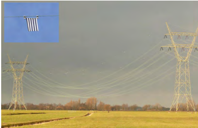
Fig 8.2b: 150kV vakwerkverbinding met vogelflappen in de bliksemdraden
