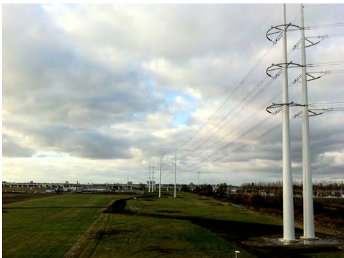
Fig. 8.2a: Opeenvolging van hoekmast – steunmast – hoekmast zoals recent gebouwd ten zuiden van de A12 bij station Bleiswijk. De hoek- en trekmasten die vanaf nu gebouwd worden hebben een kleiner verschil in HOH-afstand.
